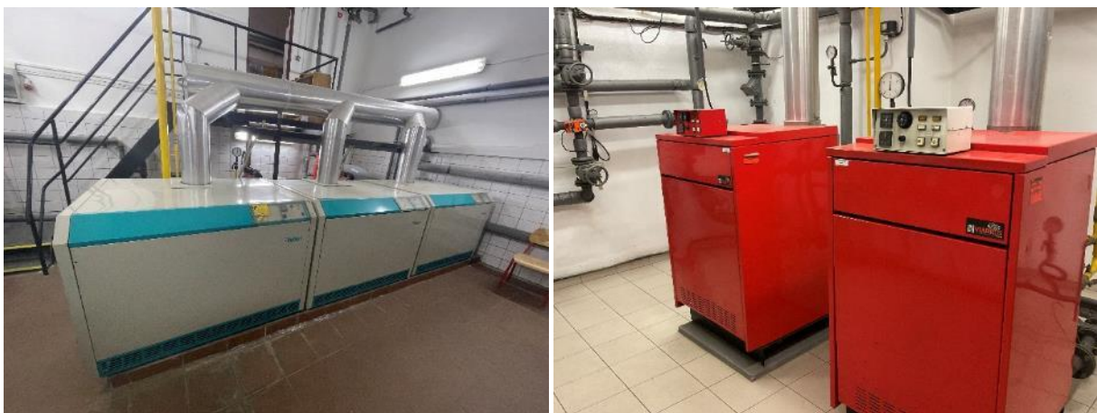
Obrázek 62 Plynové kotle v kotelně ZŠ Norbertov (vlevo) a MŠ Terronská (vpravo) Zdroj: místní šetření
