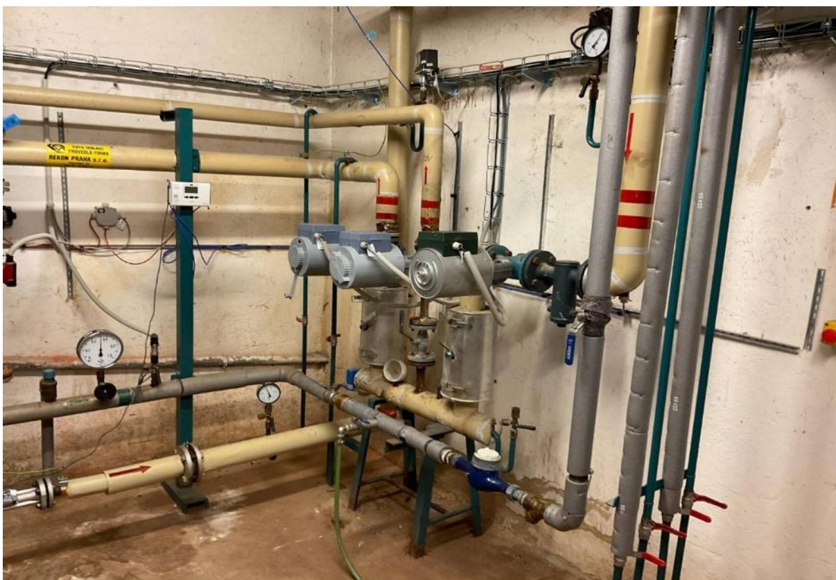
Obrázek 59 Neizolovaný výměník MŠ Volavkova Zdroj: místní šetření
