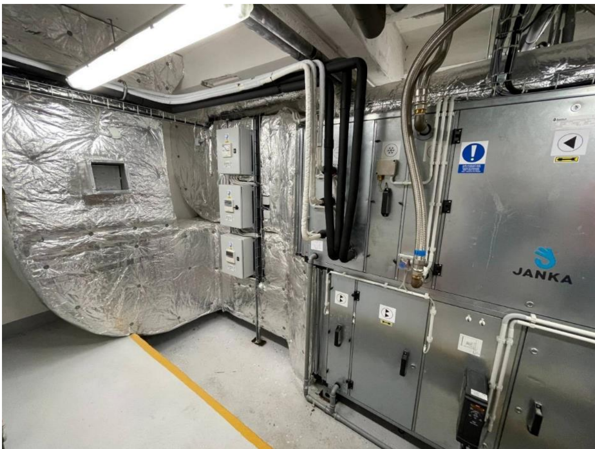
Obrázek 61 VZT jednotka ZŠ Petřiny Zdroj: místní šetření
