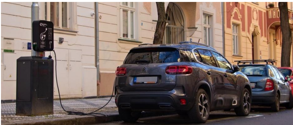
Obrázek 39 Vzorové provedení nabíjecího bodu THMP ve veřejném prostoru na EV ready lampě VO na území MČ P2 Zdroj: https://prahanabiji.smatrics.com/
