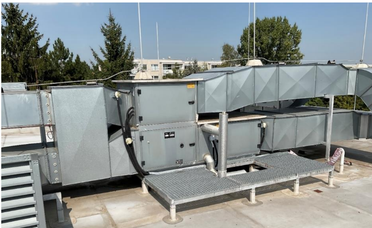
Obrázek 60 VZT s technologií ZT na střeše budovy ZŠ Dědina Zdroj: místní šetření
