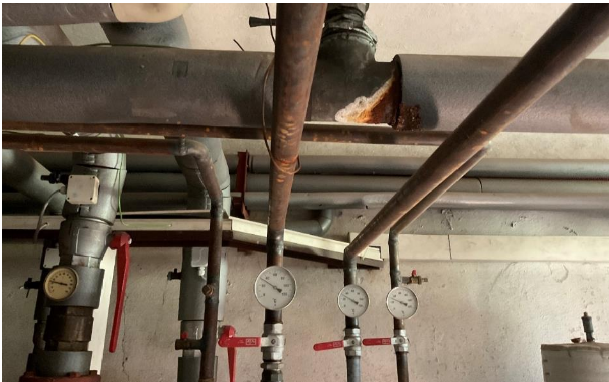
Obrázek 58 Příklad rozvodů TUV v budově ZŠ Antonína Čermáka Zdroj: místní šetření
